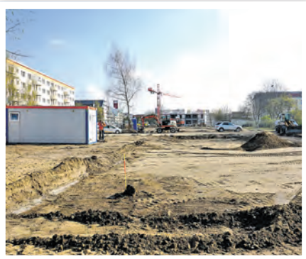
Dort, wo früher der Wohnblock 1–8 der Clara-Zetkin-Straße stand, werden ein Stadthaus und zwei Reihenhäuser gebaut.
